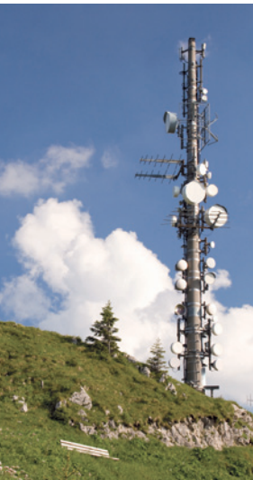
Mobilfunk-Sendestationen verbrauchen sehr viel Energie.
