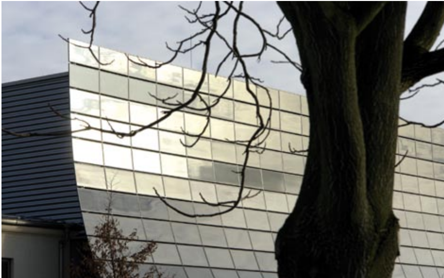
Die neue Solarwand am FBH.
